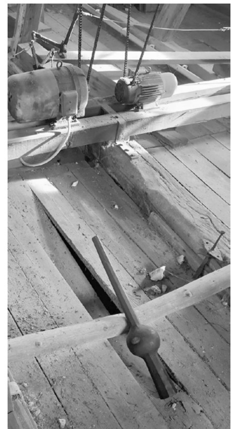
Abgebrochener Klöppel auf dem Glockenboden.
