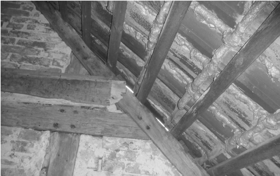
Dachpfannen und Gebälk der St. Johannis-Kirche müssen saniert werden.
